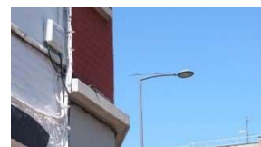
PB en façade
